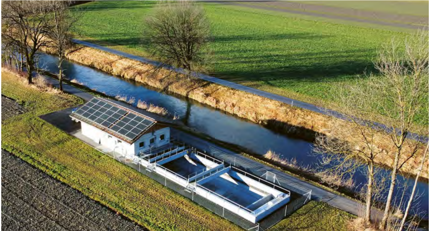
Pumpwerk mit Regenüberlaufbecken Fohlenweid
