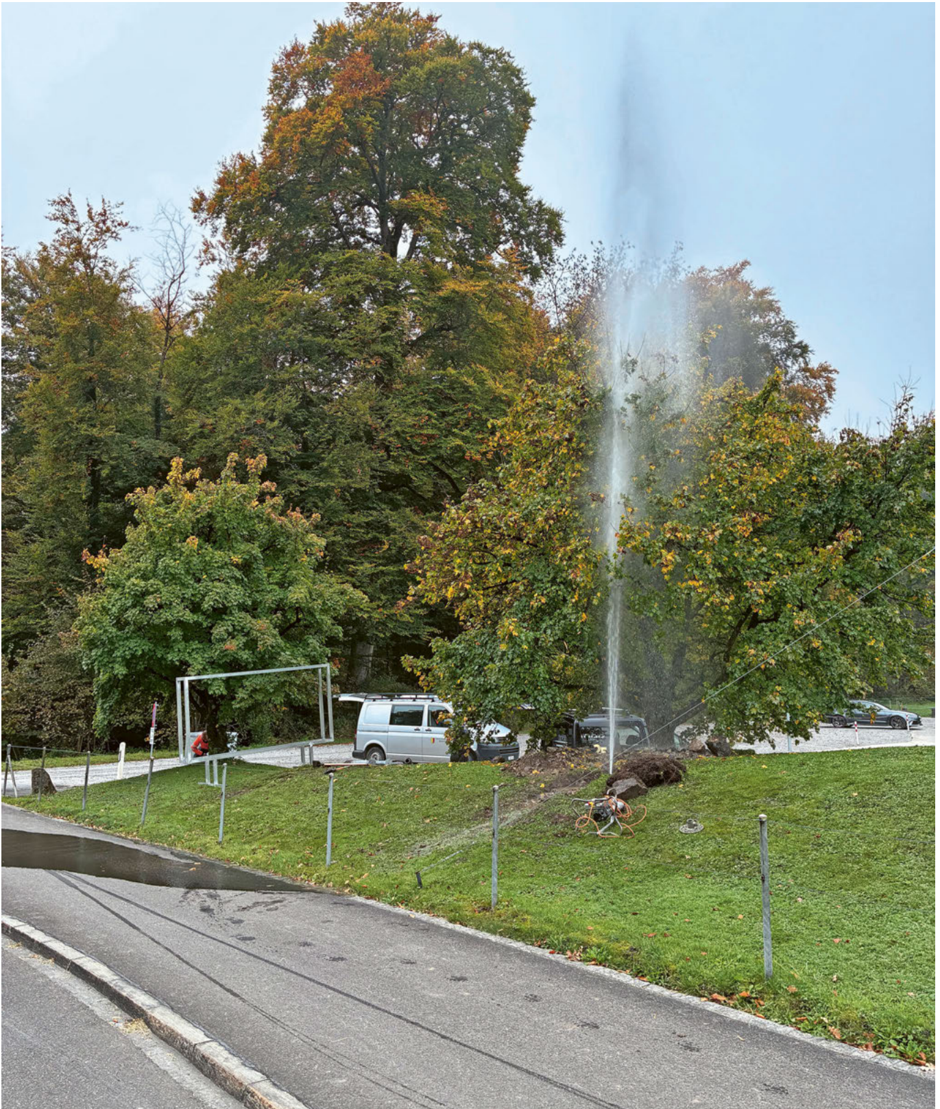
Leitungsschaden beim Forstegg
